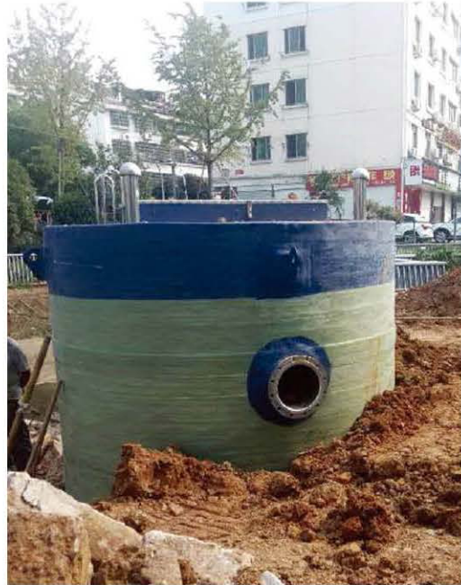
小区雨污水泵站
