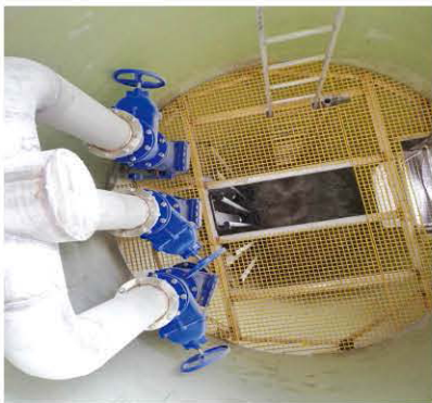
检修平台和出水管路
