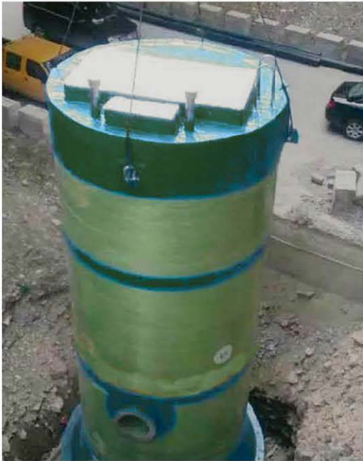
立交排水泵站
